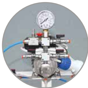
Particolare controllo erogazione e pressione
